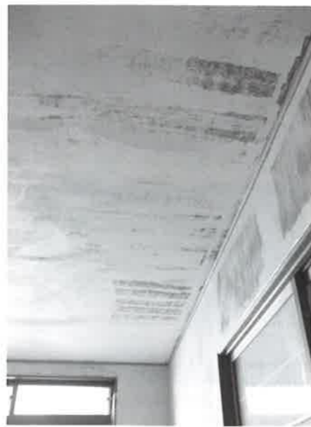
▲下塗り後、合板下地からアクが出たリフォーム現場
